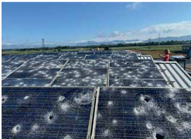
Figura 8 – Danni da grandine su un impianto fotovoltaico (luglio 2023)
